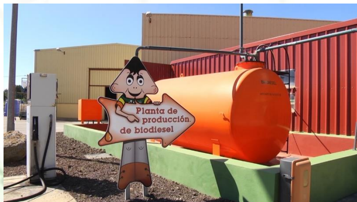
Fig. 4 Planta de producción de biodiesel. Fuente: Cabildo de El Hierro.
